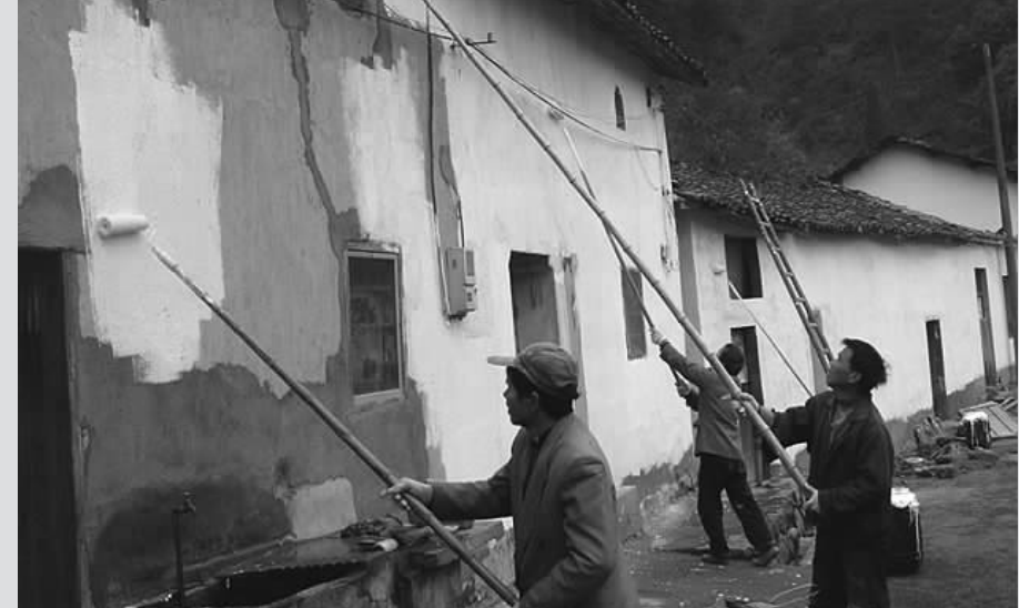
日前,枫树岭镇已完成风情小镇沿街21幢13000平方米的重点建筑立面整治。下姜村已完成重点建筑整治41幢改造面积16391平方米。窄尔、伊家两个自然村30000余平方米的一般建筑整治,现已完成总工程量的80%。(见习记者 牛瑞鹏)
